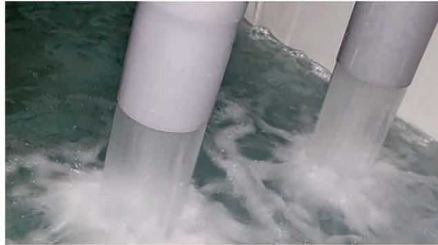
Figura 5.8. Vaso de compensación en piscina climatizada
